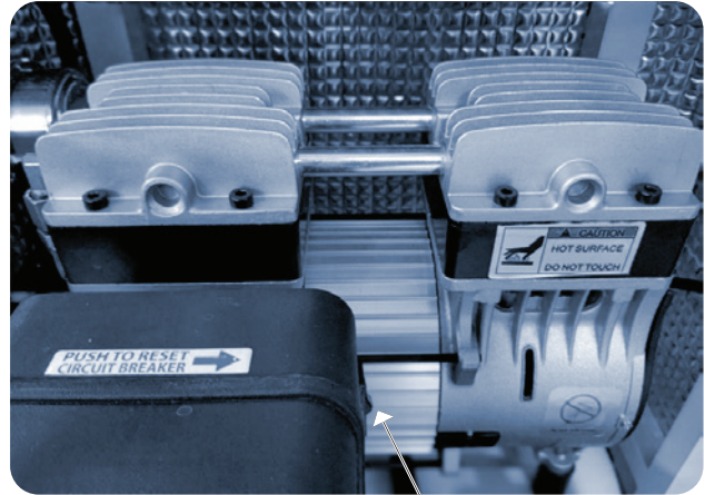
INTERRUPTOR DE CIRCUITO: PRESIONAR PARA REINICIAR
